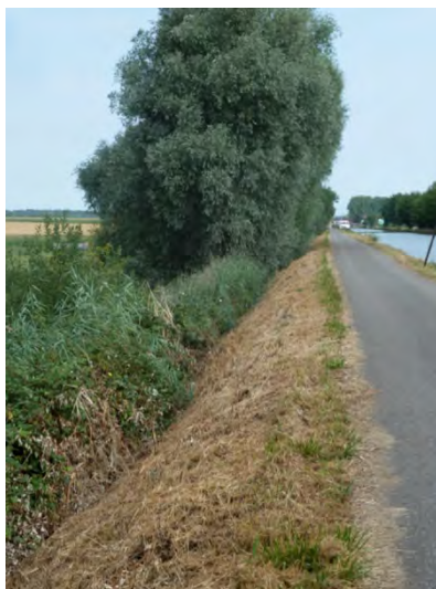
Figure 9 : Bordure herbeuse d'un canal broyée au printemps et non exportée (à éviter).
