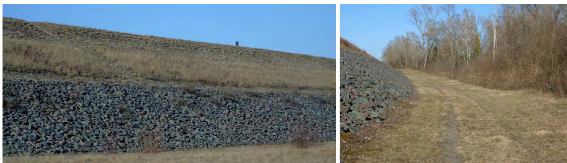
Figures 29 : Aspect de la digue sur l'île de Marckolsheim avec de gros blocs de pierres à la base, une zone refuge non fauchée à mi-hauteur ; à droite un chemin herbeux au pied de la digue (février 2018).
