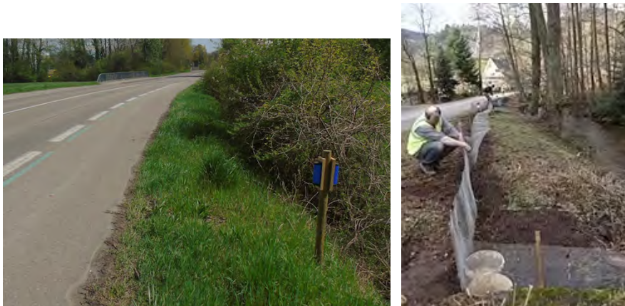
Figure 47 : A gauche un déflecteur anticollision installé en bordure de route ; à droite, la pose d'un filet à batraciens. ©Cathy Zell
