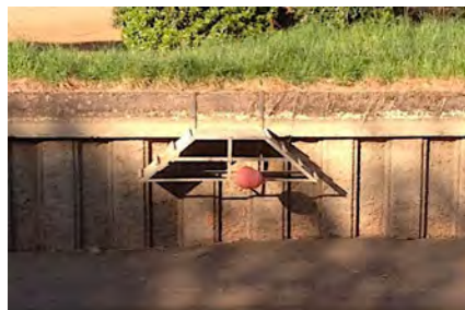
Figure 15 : Système permettant la remontée de la faune hors de l'eau ; photo prise lors d'une vidange du canal. ©N. Buhrel
