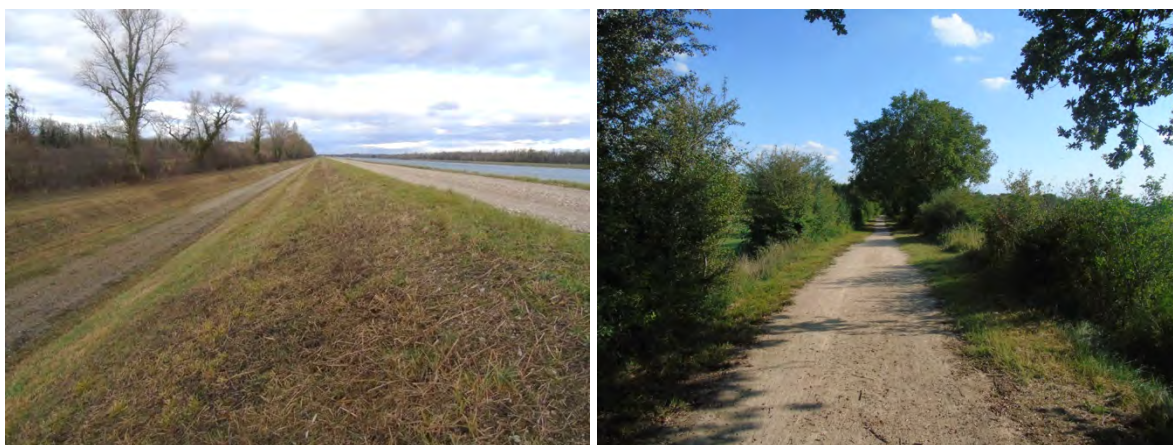
Figure 16 : A gauche, une digue du Rhin canalisé recouvert d'une végétation herbacée entretenue ; à droite, une ancienne digue du XIXe siècle avec ses flancs couverts de haies et de friches herbeuses.
