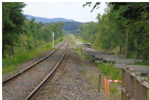
Figure 36 : Chantier de remplacement des traverses en bois par d’autres en béton (déposées sur le côté droit de l’image).
