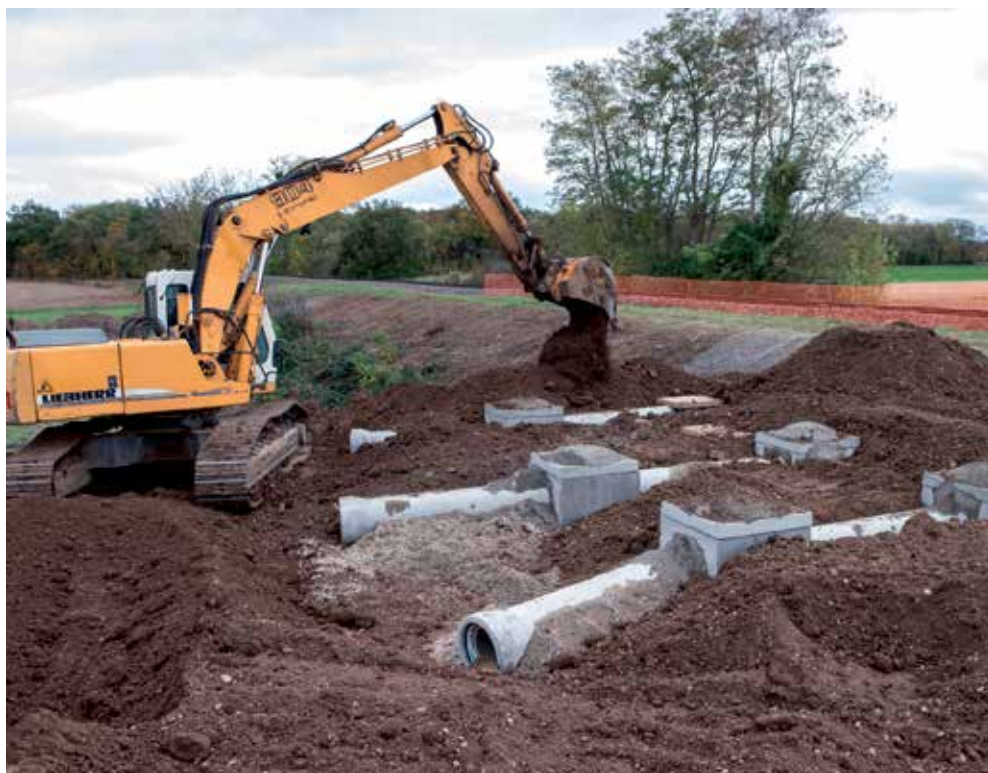
Envelissement des caissons et des galeries de béton (photo SNCF Grand-Est)
